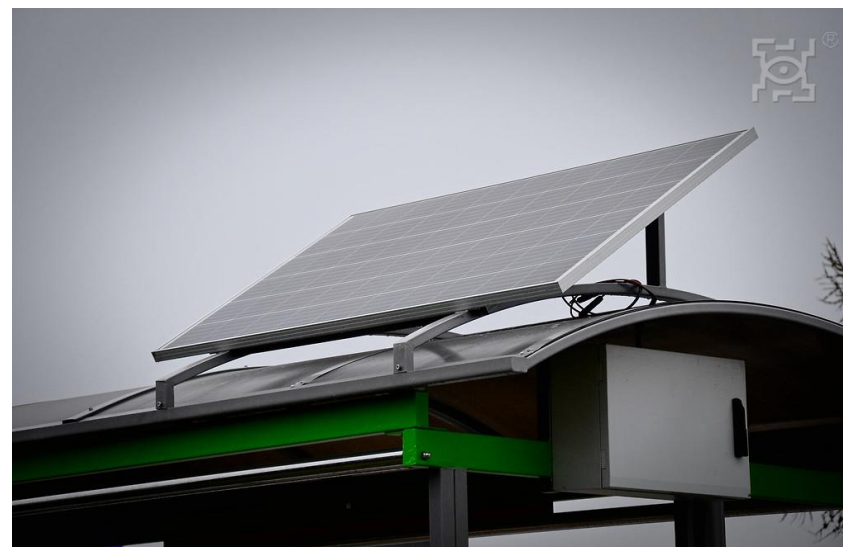
Rys. 2.1 Panele fotowoltaiczne na wiatkach przystanków autobusowych, wykorzystywane jako dodatkowe alternatywne źródło energii.
